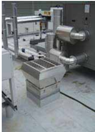
Bild 12: Zentralablüfter der Hotelzimmerbäder
