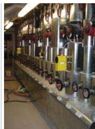
Bild 6: Heizungsverteiler (links) und Pufferspeicher (rechts)
