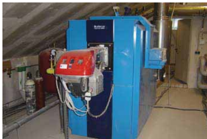
Bild 4: Heizkessel mit Brenner und Druckhaltung (hinten links) der Heizungsanlage
